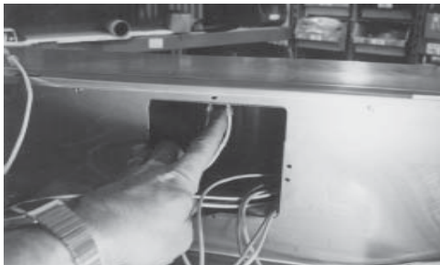
Cooling Fan High Limit
