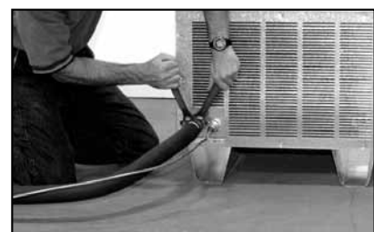
Conexión al lado de la Unidad de condensación
