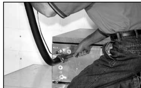
Conexión al lado de la Sección evaporadora
